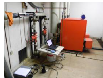
Figura 15. Mediciones de demanda y consumo de energía en sala de calderas. Edificio MOP Puerto Montt.
