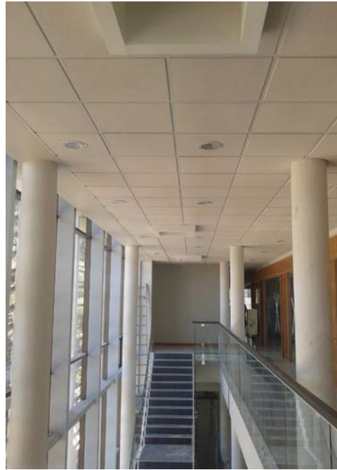
Figura 4.13. Espacio atrio de triple altura para ventilación convectiva, Contraloría Regional de la Araucanía, Temuco (zona 7 SI) (BGL arqtos., responsable Juan Claudio López Rubke). Ventanas practicables en la parte inferior y troneras de ventilación en el techo generan el efecto convectivo.
