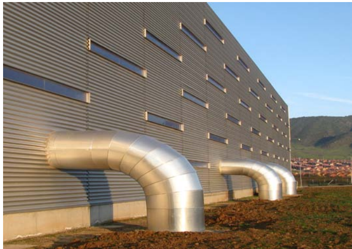
Figura 4.23. Tubos intercambiadores geotérmicos en Centro de Distribución y Logística FASA (zona 5C) (Guillermo Hevia arqto.)
