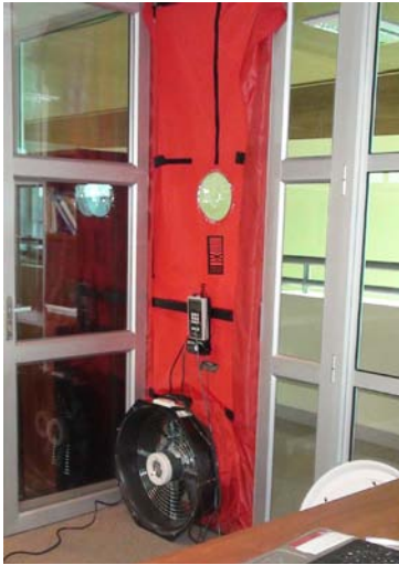
Figura 11. Mediciones de permeabilidad al aire de la envolvente. Edificio Policía de Investigaciones de Puerto Montt.
